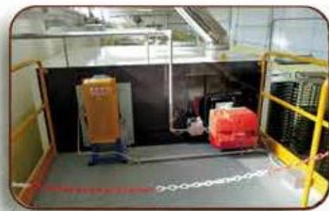
3 Zona fornello: bruciatore e ventilatore fumi. Burner area: burner and flue gas ventilator fan.
